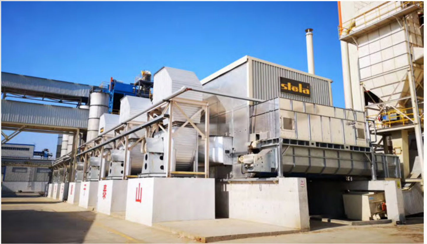
项目地：山东丰源, 中国 | 型号：BTU 1/6200-60 | 安装年份：2018 干燥物料：OSB定向刨花板 | 出料能力：约15.0吨/小时 | 降水区间：100% - 2%含水率
