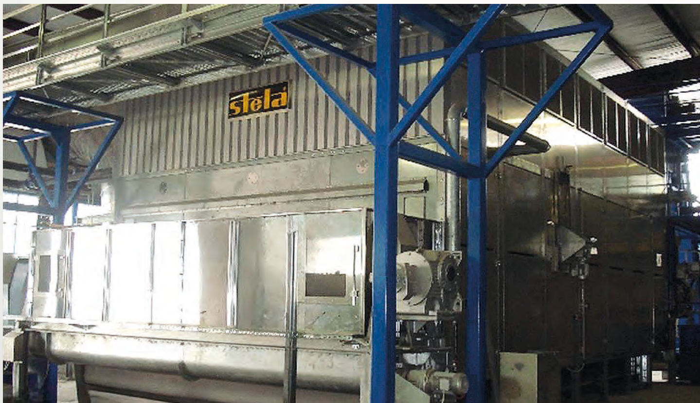
项目地：Finvest, 克罗地亚 | 型号：BT 1/6200-10.5 | 安装年份：2007 干燥物料：木屑 | 出料能力：约3.6吨/小时 | 降水区间：50% - 13%湿度
