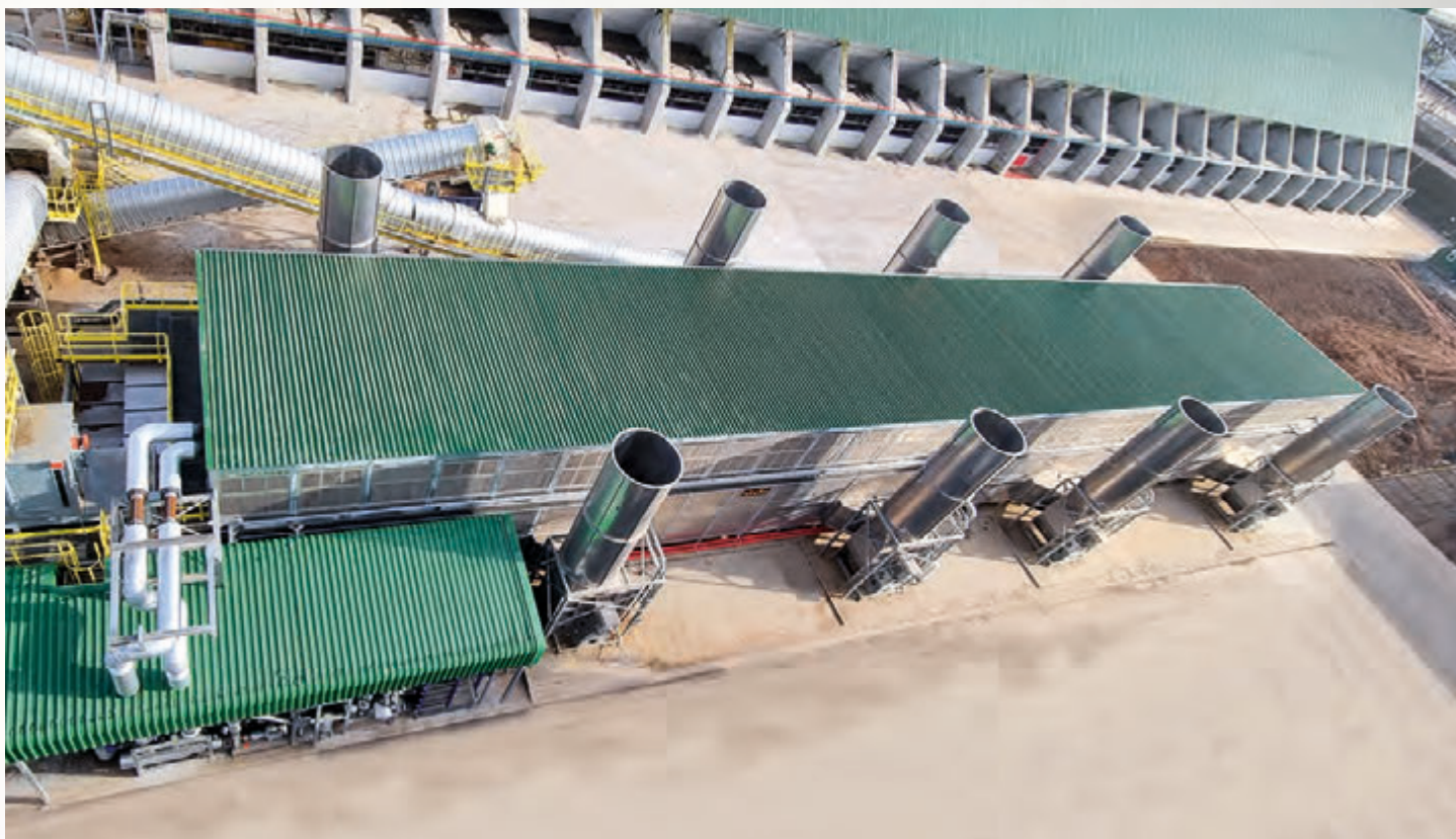
项目地：Berneck S.A., 巴西 | 型号：BT 1/8400-58.5 | 安装年份：2022 干燥物料：松树皮和木屑 | 出料能力：约80.0吨/小时 | 降水区间：60% - 5%湿度
