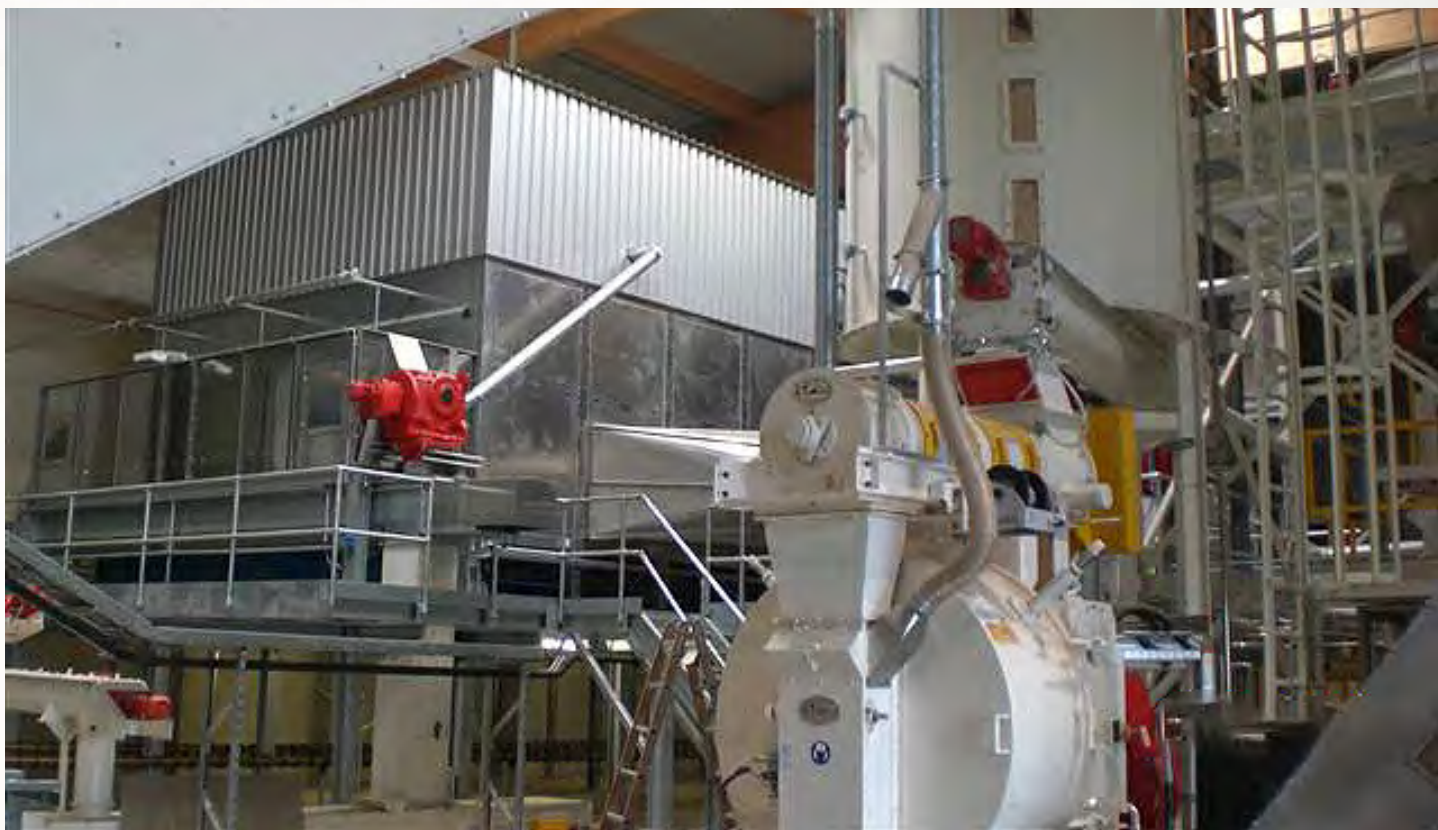
项目地: Bioenergie Dotternhausen GmbH & Co. KG, 德国 | 型号: BT 1/6200-19.5 | 安装年份: 2012 干燥物料: 木屑 | 出料能力: 约6.7吨/小时 | 降水区间: 47% - 9%湿度
