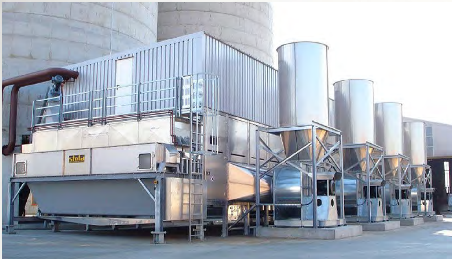
项目地：Holzindustrie Schweighofer, 罗马尼亚 | 型号：BT 1/6200-37.5 | 安装年份：2008 干燥物料：木屑 | 出料能力：约11.6吨/小时 | 降水区间：50% - 10%湿度
