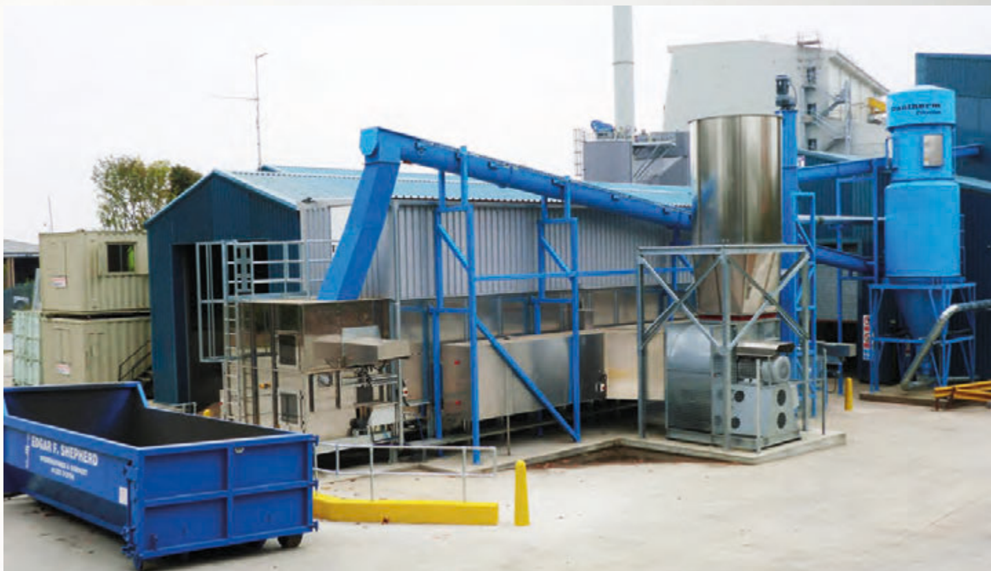
项目地: Dalkia UK, 英国 | 型号: BT 1/2700-13 | 安装年份: 2012 干燥物料: 木片 | 出料能力: 约7.0吨/小时 | 降水区间: 22.5% - 10%湿度
