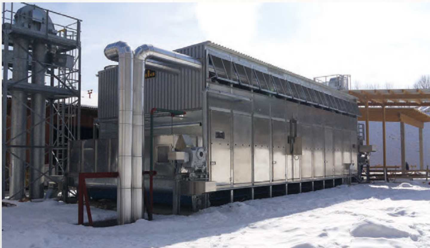
项目地：H. u. H. Pellets, 奥地利 | 型号：BT 1/6200-16.5 | 安装年份：2009 干燥物料：木屑 | 出料能力：约6.0吨/小时 | 降水区间：50% - 10%湿度
