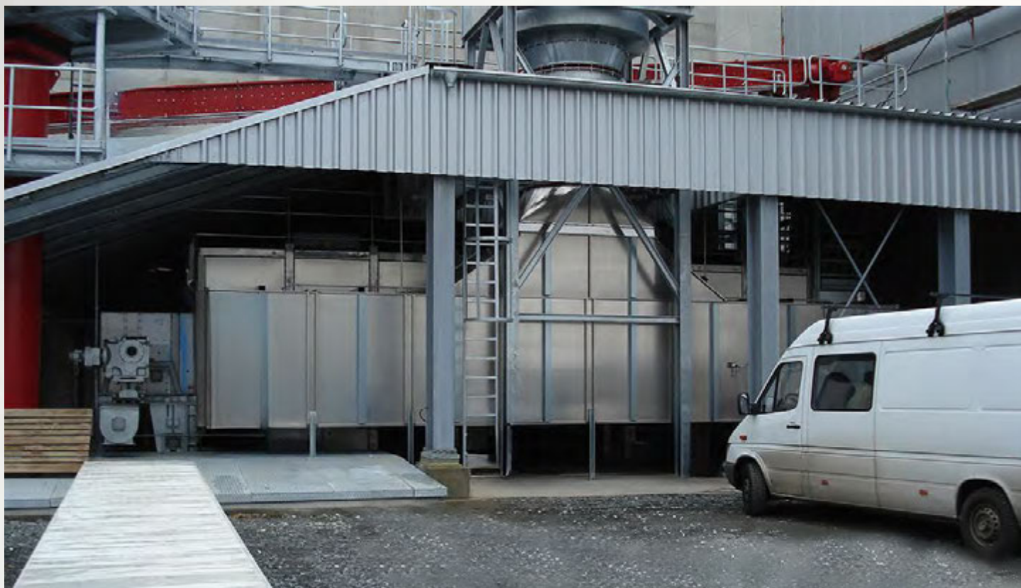
项目地：UET Choren, 德国 | 型号：BT 1/6200-12 | 安装年份：2006 干燥物料：木片 | 出料能力：约4.5吨/小时 | 降水区间：35% - 10%湿度
