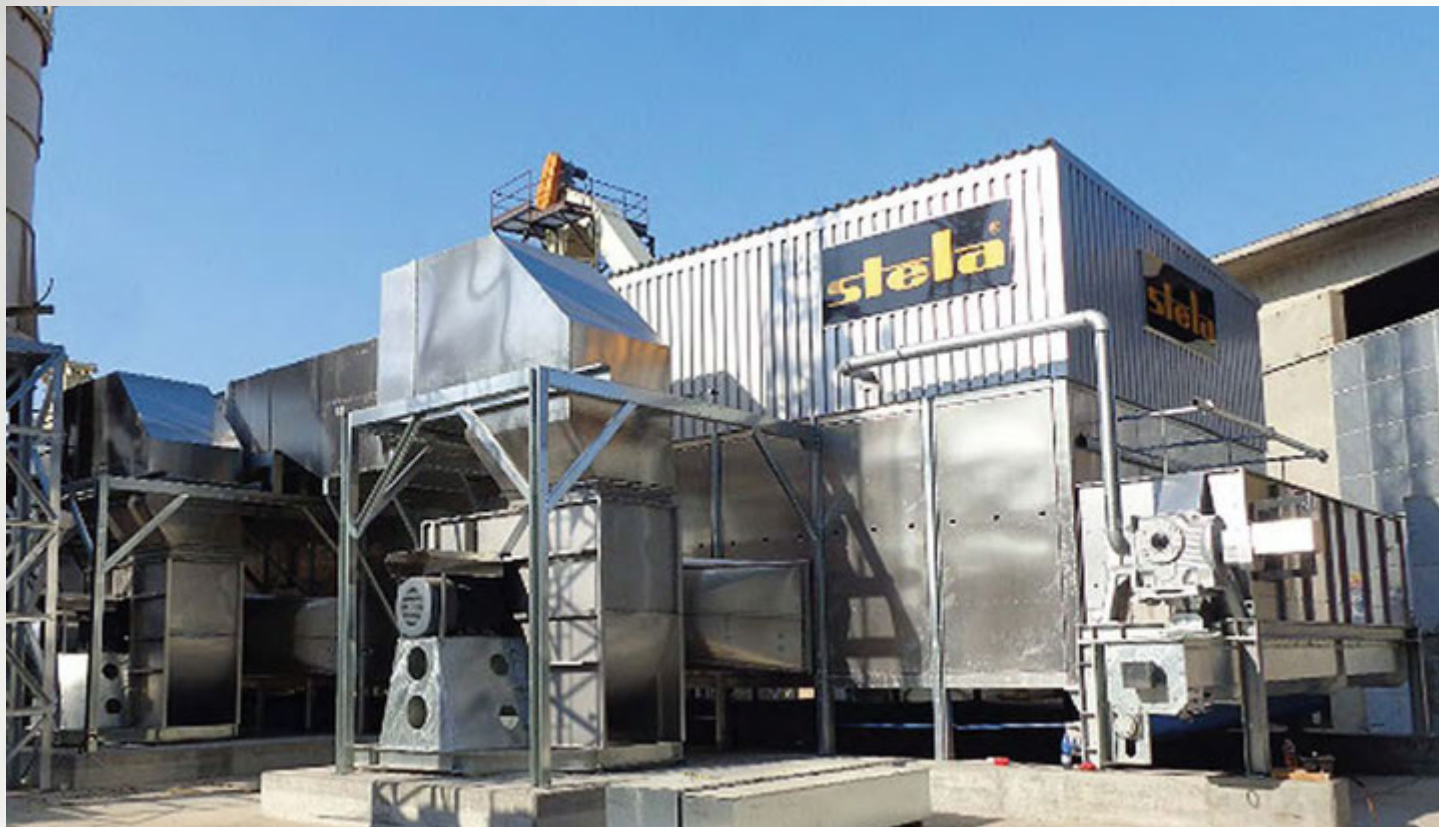
项目地：Invernizzi S.P.A., 意大利 | 型号：BTU 1/6200-27 | 安装年份：2016 干燥物料：木屑 | 出料能力：约4.5吨/小时 | 降水区间：55% - 1%湿度
