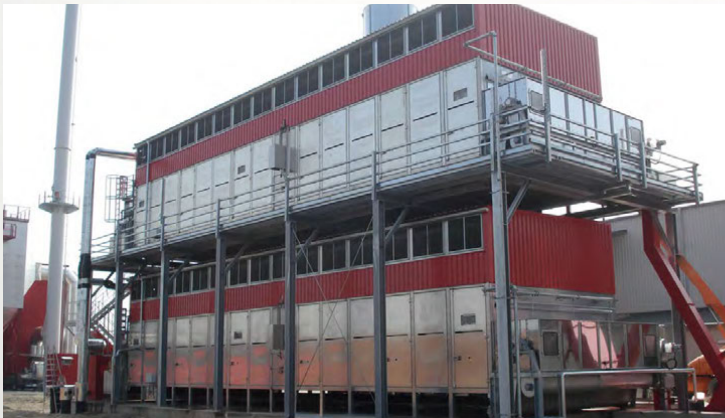
项目地：JRS Holzenergie, 德国 | 型号：2x BT 1/6200-22.5 | 安装年份：2006 干燥物料：木片 | 出料能力：约13.0吨/小时 | 降水区间：50% - 10%湿度
