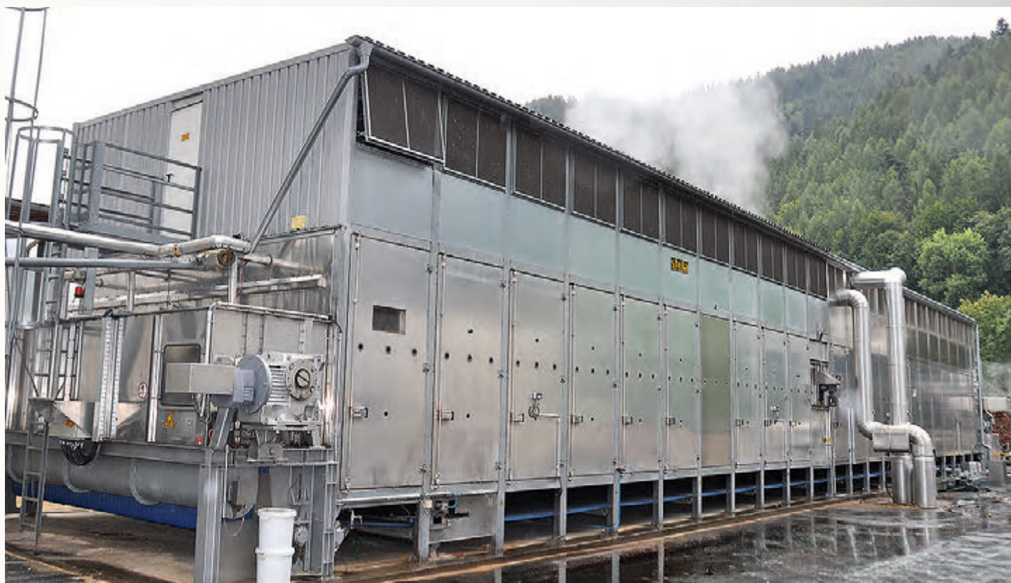
项目地：Mayr-Melnhof Pellets, 奥地利 | 型号：BT 1/6200-34.5 | 安装年份：2013 干燥物料：木屑 | 出料能力：约8.3吨/小时 | 降水区间：53% - 10%湿度
