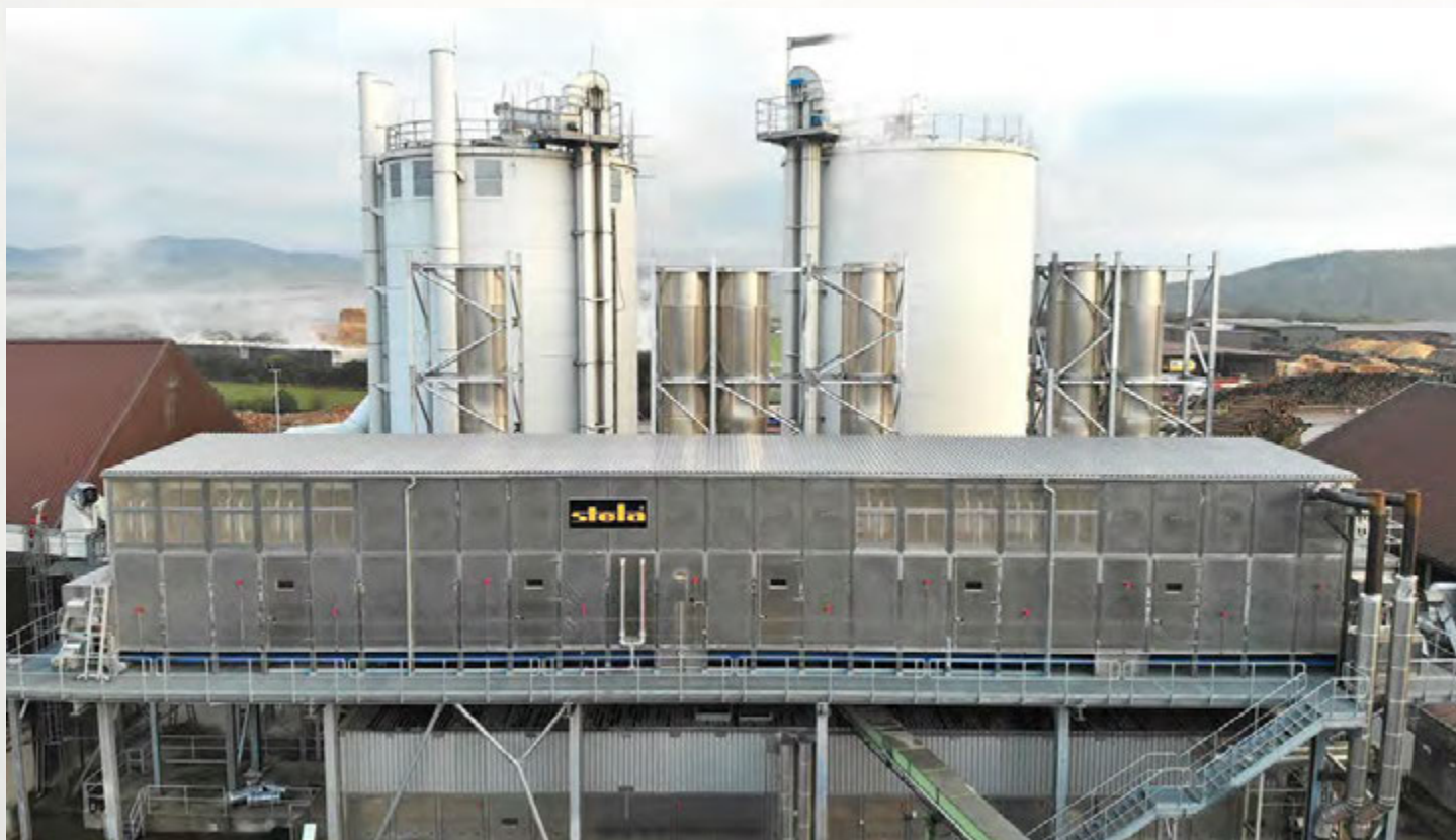
项目地：Ante Leimholz, 德国 | 型号：BTU 1/6200-37.5-5/3 | 安装年份：2021 干燥物料：木屑 | 出料能力：约11.0吨/小时 | 降水区间：50% - 10%湿度
