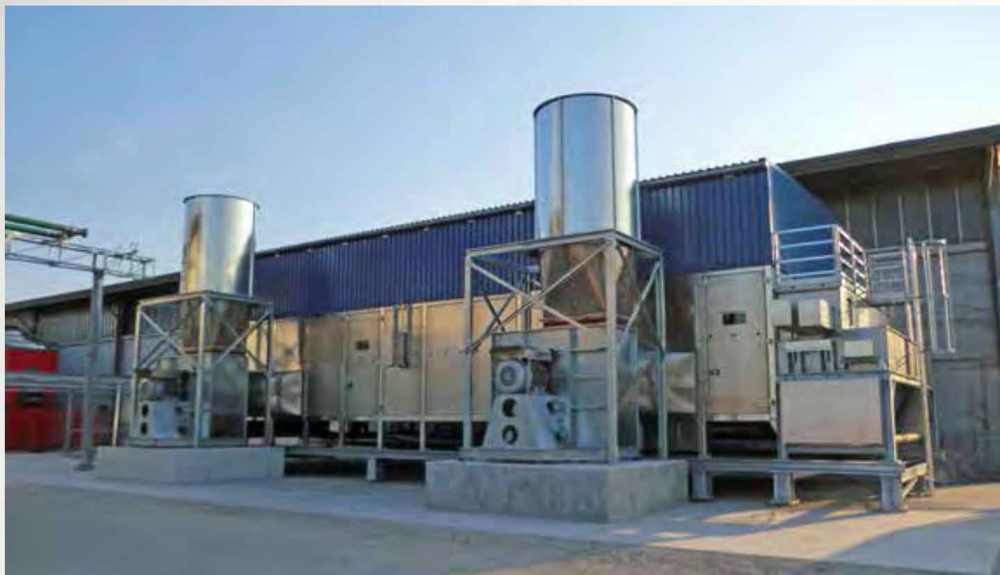
项目地：La Tiesse s.r.l., 意大利 | 型号：BT 1/6200-19.5 | 安装年份：2013 干燥物料：木屑 | 出料能力：约6.0吨/小时 | 降水区间：50% - 10%湿度
