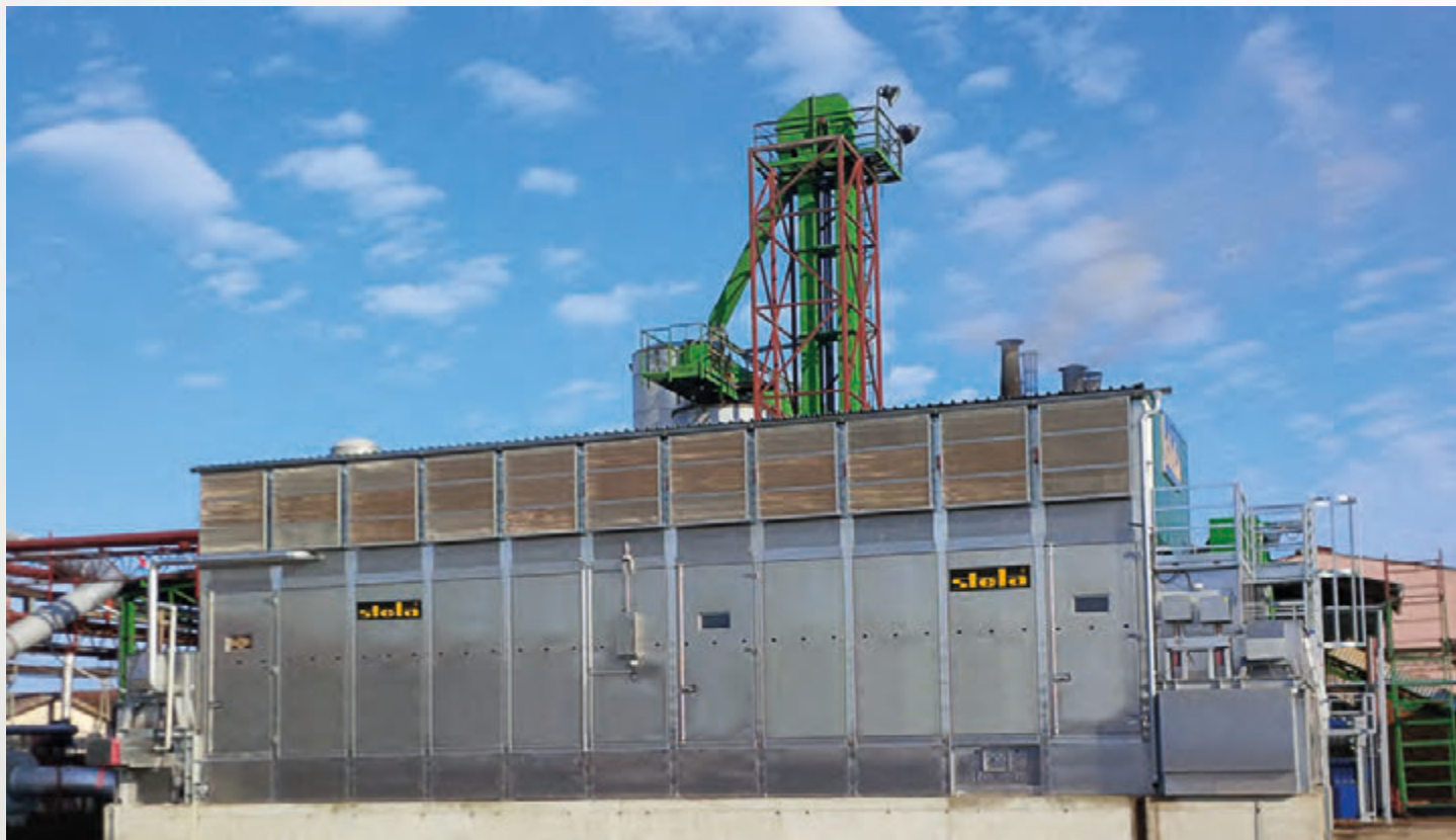
项目地：Spacva d.d., 克罗地亚 | 型号：BT 1/6200-16.5 | 安装年份：2014 干燥物料：木屑 | 出料能力：约6.0吨/小时 | 降水区间：50% - 10%湿度
