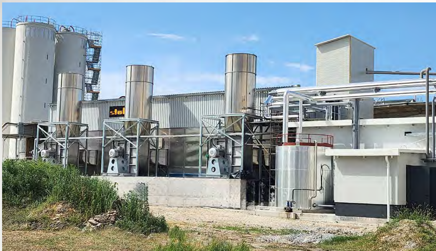
项目地: Dunacell Kft, 匈牙利 | 型号: BT 1/6200-24 | 安装年份: 2023 干燥物料: 纤维碎片 | 出料能力: 约5.0吨/小时 | 降水区间: 60% - 10%湿度
