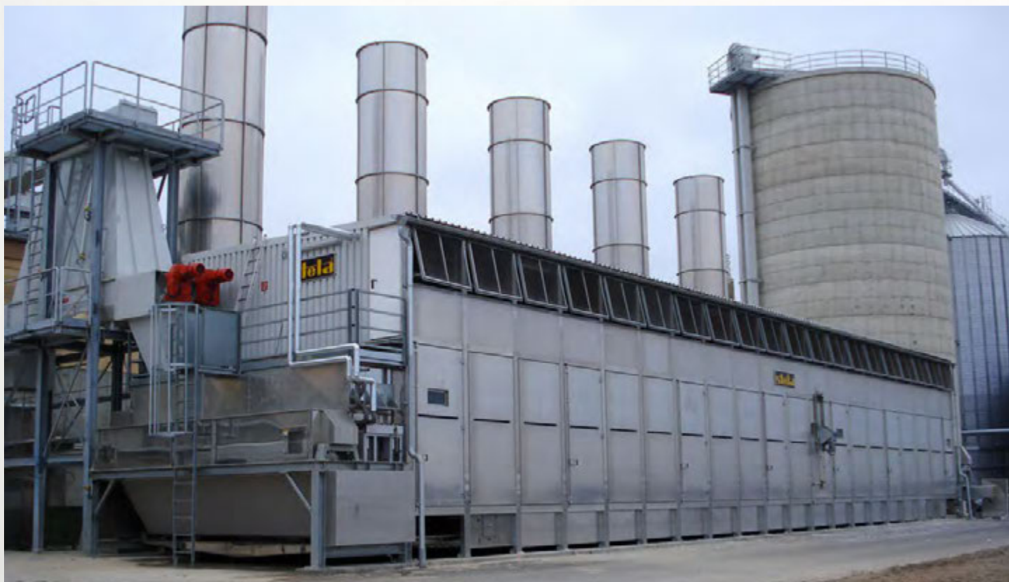
项目地：Pelletproduktion Sachsen-Anhalt Süd, 德国 | 型号：BT 1/6200-30 | 安装年份：2008 干燥物料：木屑 | 出料能力：约9.5吨/小时 | 降水区间：50% - 10%湿度
