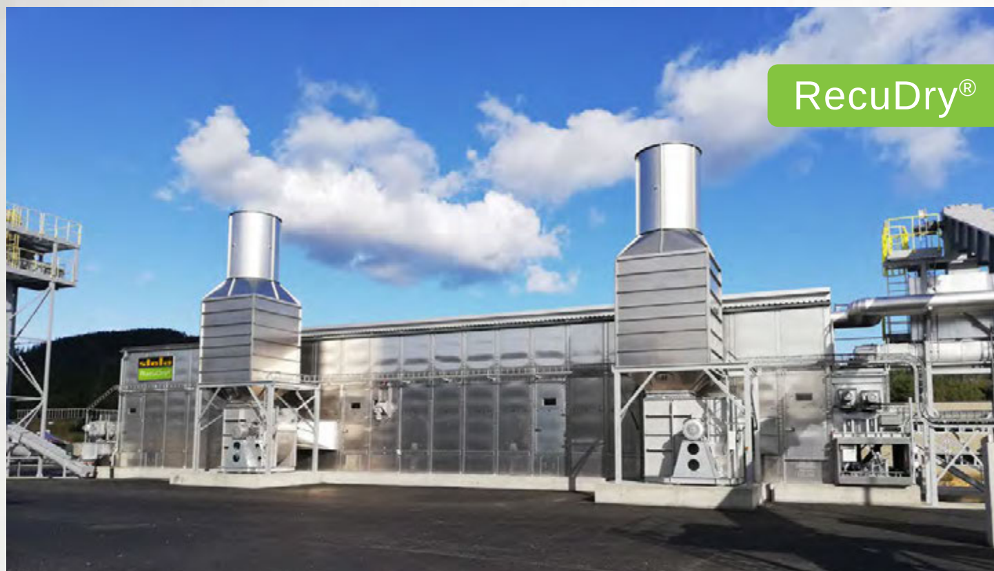
项目地: Hekotek Moelven, 挪威 | 型号: BTU RecuDry 1/6200-33 | 安装年份: 2019 干燥物料: 木屑 | 出料能力: 约10.6吨/小时 | 降水区间: 53% - 10%湿度
