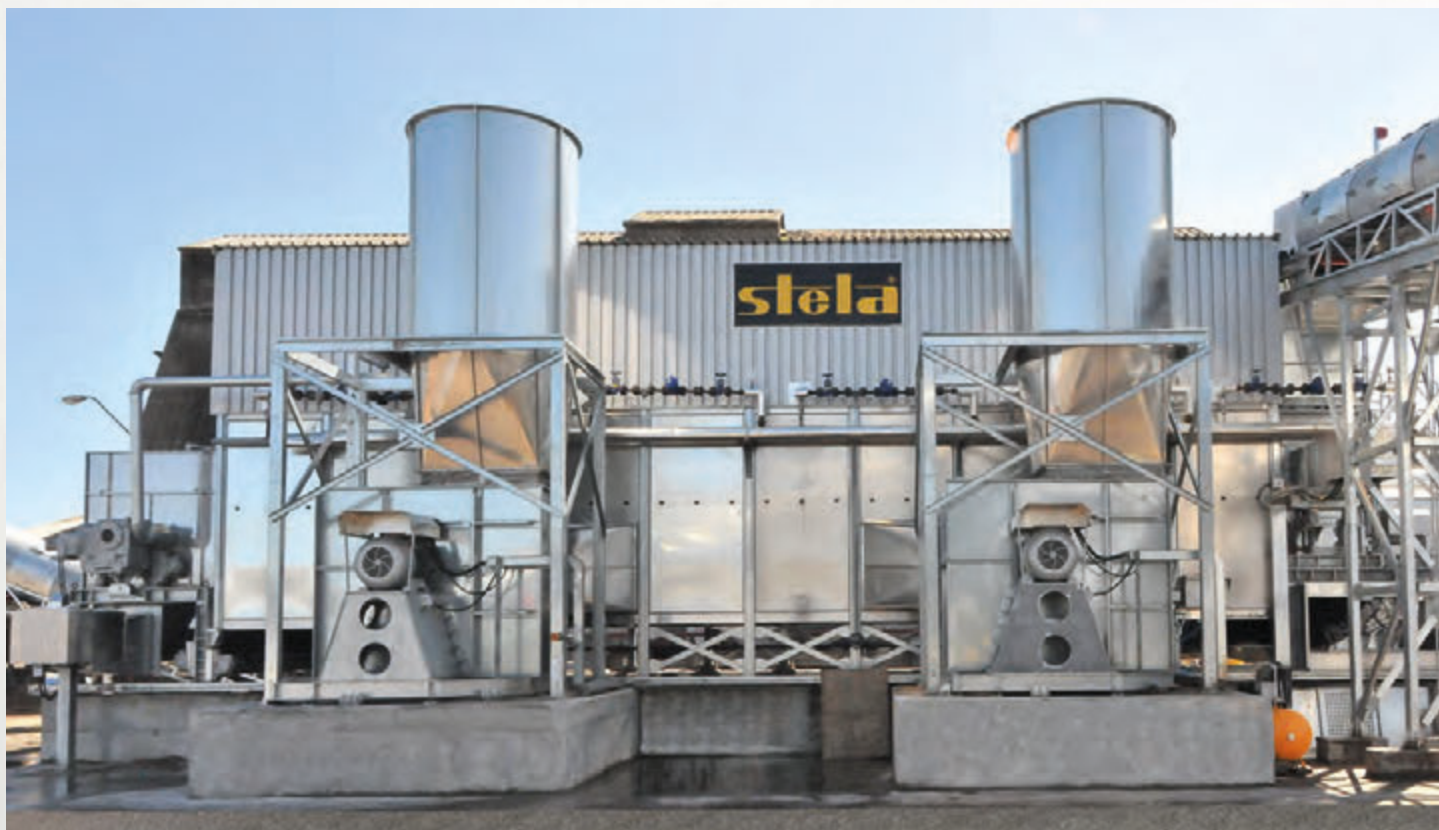
项目地: Electrica Nueva Energia S.A., 智利 | 型号: BT 1/6200-15 | 安装年份: 2015 干燥物料: 木片、树皮 | 出料能力: 约15.7吨/小时 | 降水区间: 57% - 45%湿度
