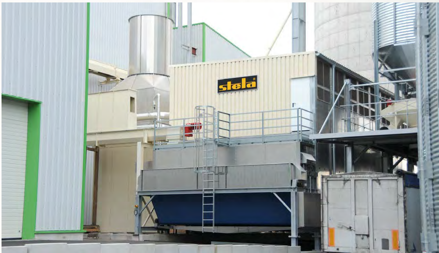
项目地：Energiepellets, 德国 | 型号：BT 1/6200-18 | 安装年份：2010 干燥物料：木屑 | 出料能力：约5.5吨/小时 | 降水区间：50% - 10%湿度
