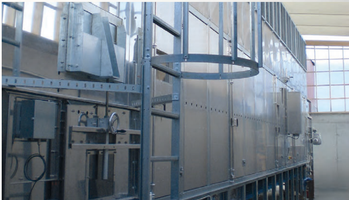
项目地: Krekula & Lauri, 瑞典 | 型号: BT 1/2700-14 | 安装年份: 2008 干燥物料: 木屑 | 出料能力: 约2.0吨/小时 | 降水区间: 50% - 10%湿度
