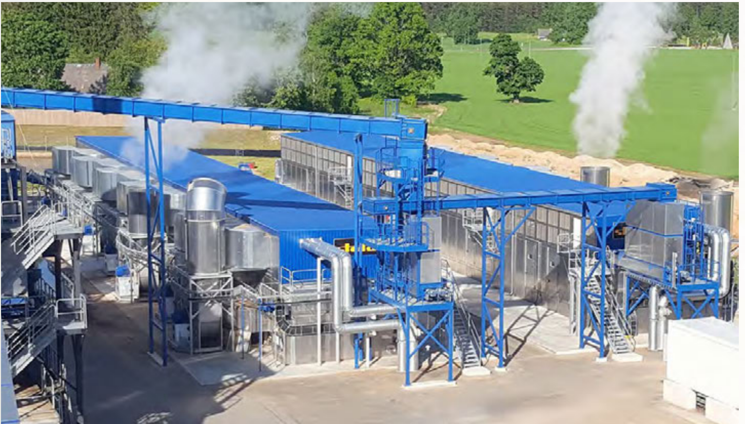
项目地：OÜ Osula Graanul, 爱沙尼亚 | 型号：2x BTU 1/6200-60 | 安装年份：2017 干燥物料：木屑、碎木片 | 出料能力：约2x 18.3吨/小时 | 降水区间：50% - 10%湿度
