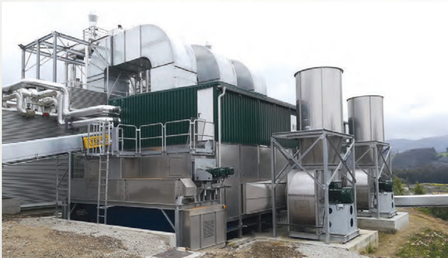
项目地：Biogastur S.A., 西班牙 | 型号：BT 1/6200-15 | 安装年份：2018 干燥物料：厌氧沼渣 | 出料能力：约3.3吨/小时 | 降水区间：72% - 40%湿度
