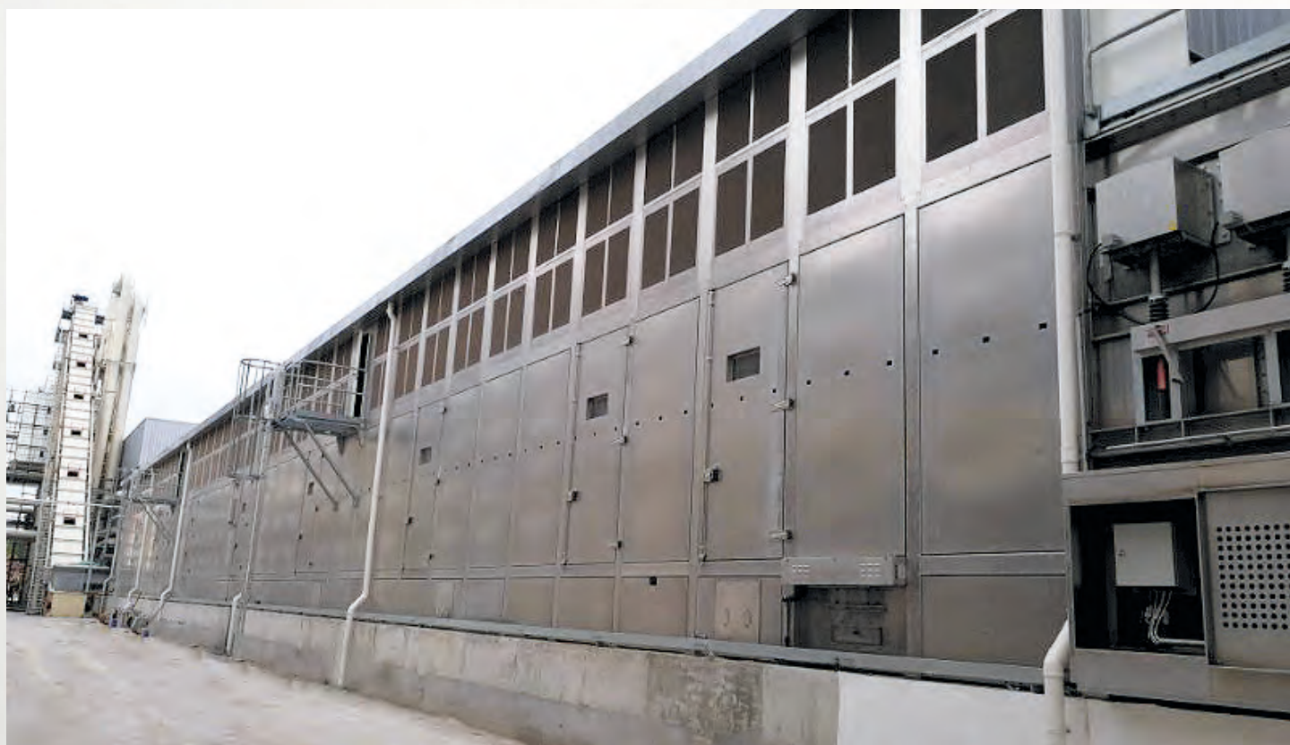
项目地：东盾木业, 中国 | 型号：BTU 1/6200-61.5 | 安装年份：2019 干燥物料：木屑、木片 | 出料能力：约25.5吨/小时 | 降水区间：80% - 2%含水率
