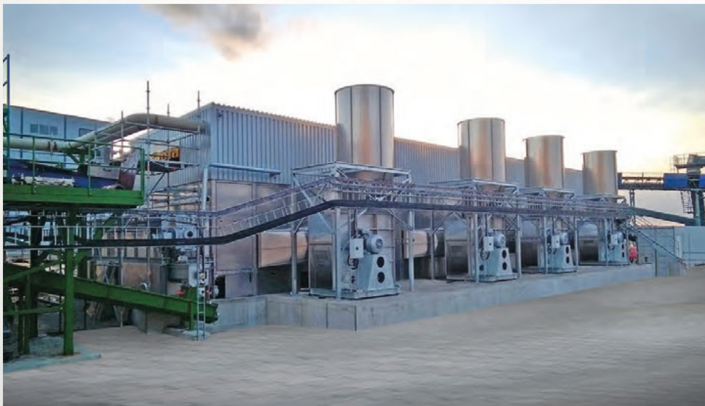
项目地：Stora Enso Ala, Sawmill, 瑞典 | 型号：BT 1/6200-28.5 | 安装年份：2016 干燥物料：木屑 | 出料能力：约8.5吨/小时 | 降水区间：55% - 10%湿度
