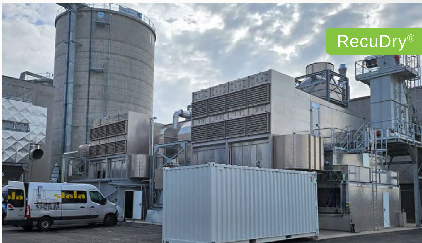
项目地：TILLY Holzindustrie, 奥地利 | 型号：BTU RecuDry 1/6200-25.5 | 安装年份：2023 干燥物料：木屑 | 出料能力：约5.9吨/小时 | 降水区间：50% - 12%湿度
