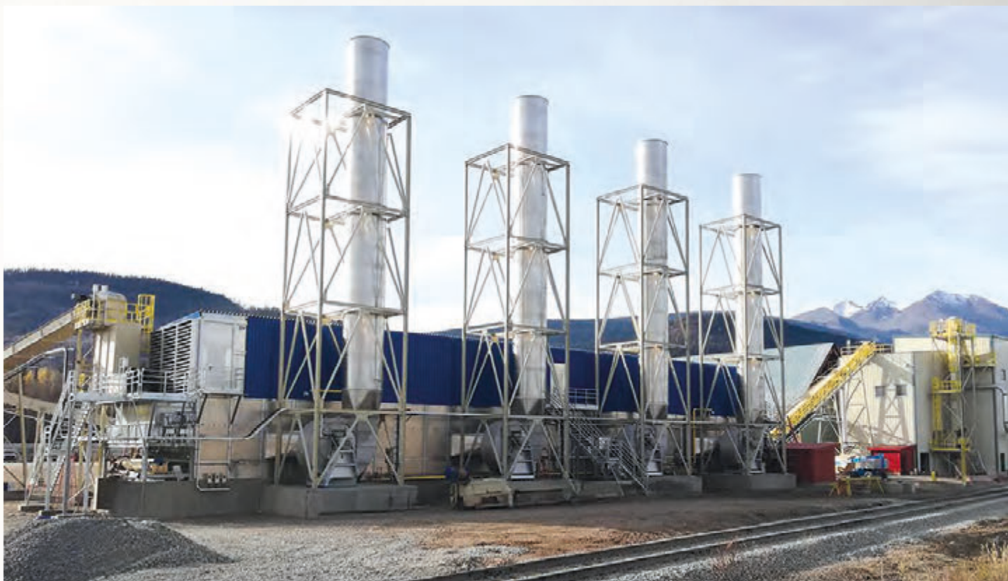
项目地：Pinnacle Renewable Energy, 加拿大 | 型号：BT 1/6200-42 | 安装年份：2018 干燥物料：刨花、木屑、木片和树皮混料 | 出料能力：约14.9吨/小时 | 降水区间：45% - 8%湿度
