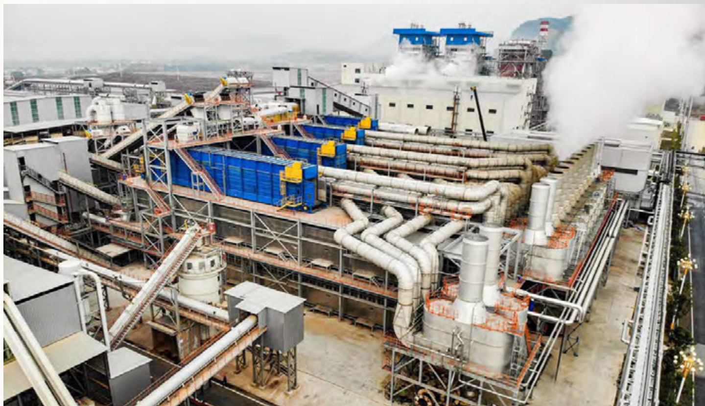
项目地：江西鲁丽木业, 中国 | 型号：4x BTU 2/6200-61.5 | 安装年份：2023 干燥物料：OSB板/LSB板 | 出料能力：约160.0吨/小时 | 降水区间：100% - 2%含水率
