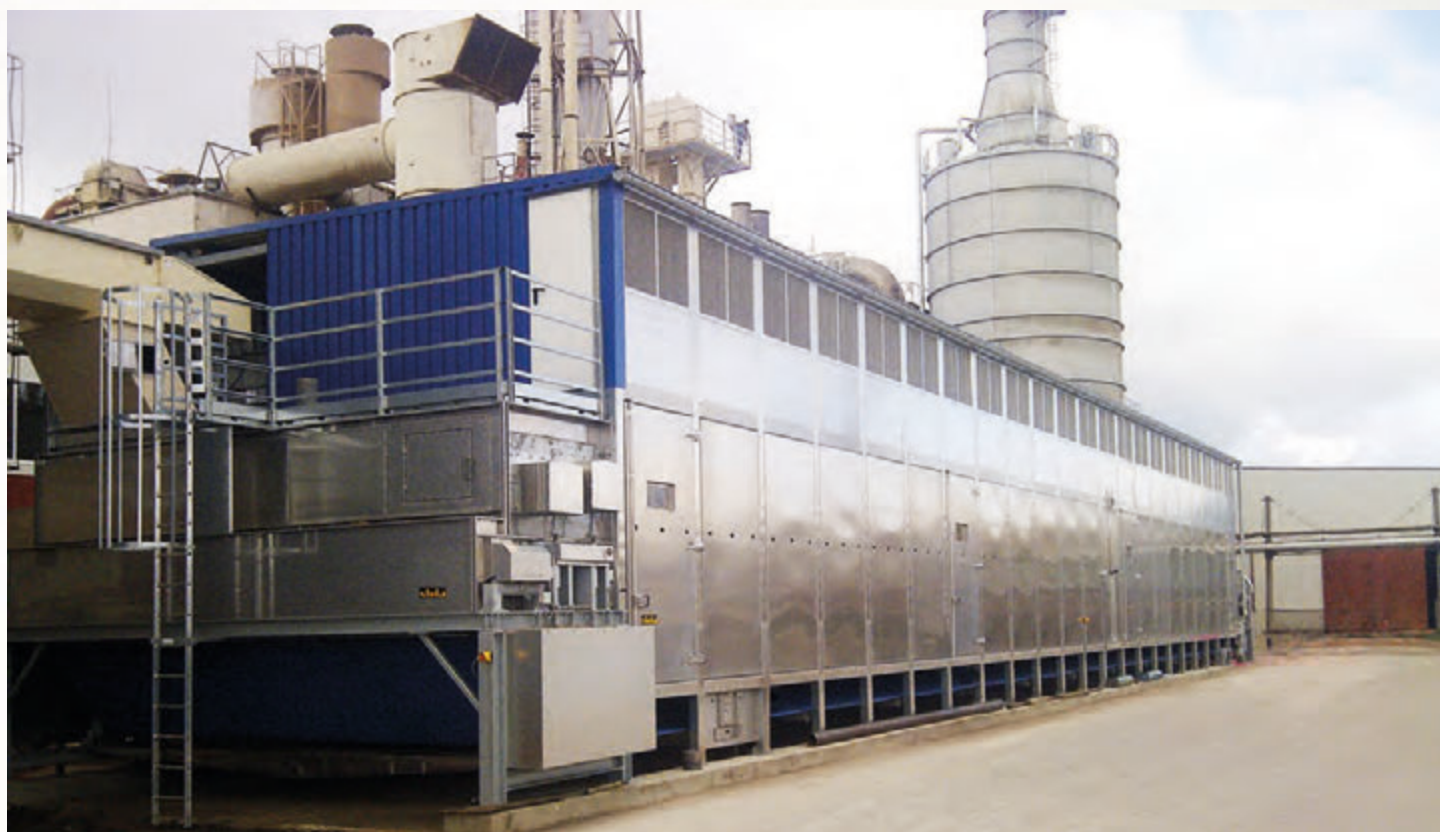
项目地：Kastamonu, 保加利亚 | 型号：BT 1/6200-33 | 安装年份：2013 干燥物料：木片 | 出料能力：约45.7吨/小时 | 降水区间：47% - 40%湿度
