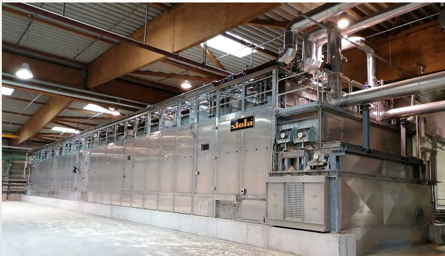
项目地：Pfeifer Holz s.r.o., 捷克 | 型号：BT 1/6200-39 | 安装年份：2019 干燥物料：木屑 | 出料能力：约11.5吨/小时 | 降水区间：53% - 10%湿度
