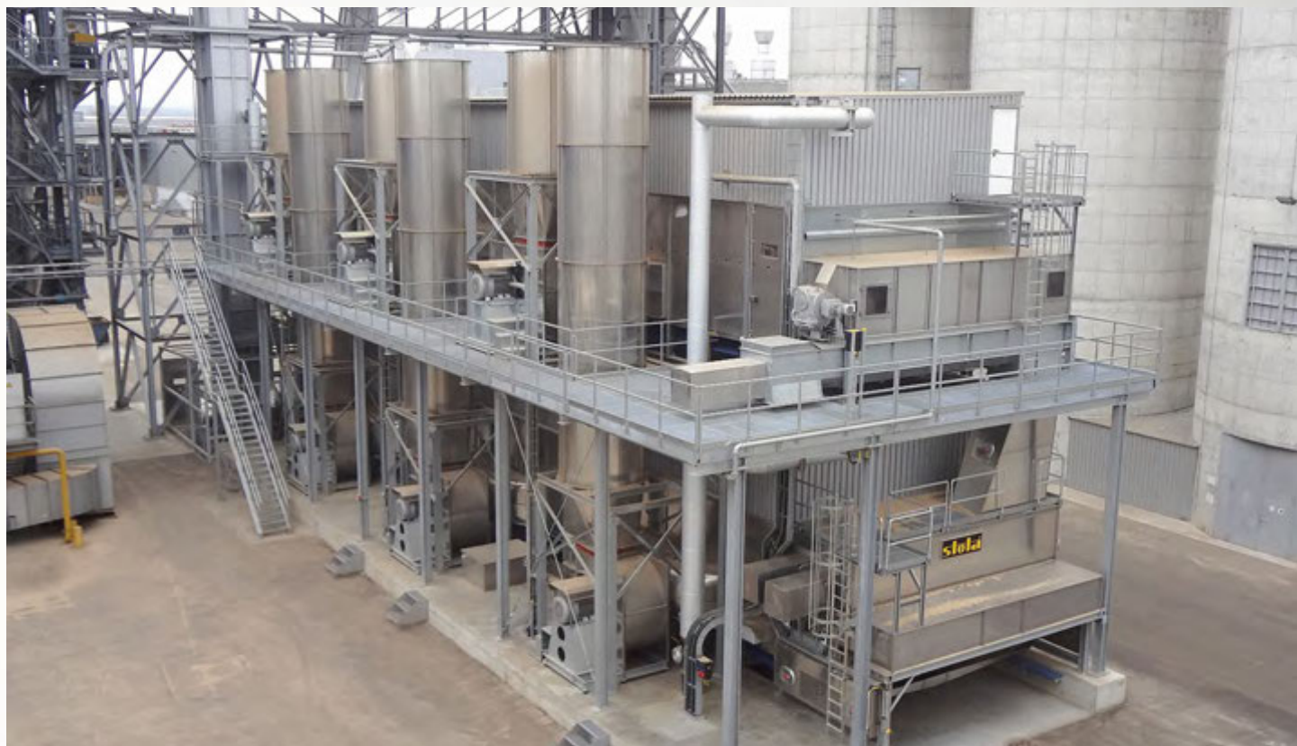
项目地：SC Egger SRL, 罗马尼亚 | 型号：BT 2/6200-28.5 | 安装年份：2013 干燥物料：细碎木片、木屑 | 出料能力：约43.0吨/小时 | 降水区间：47% - 30%湿度
