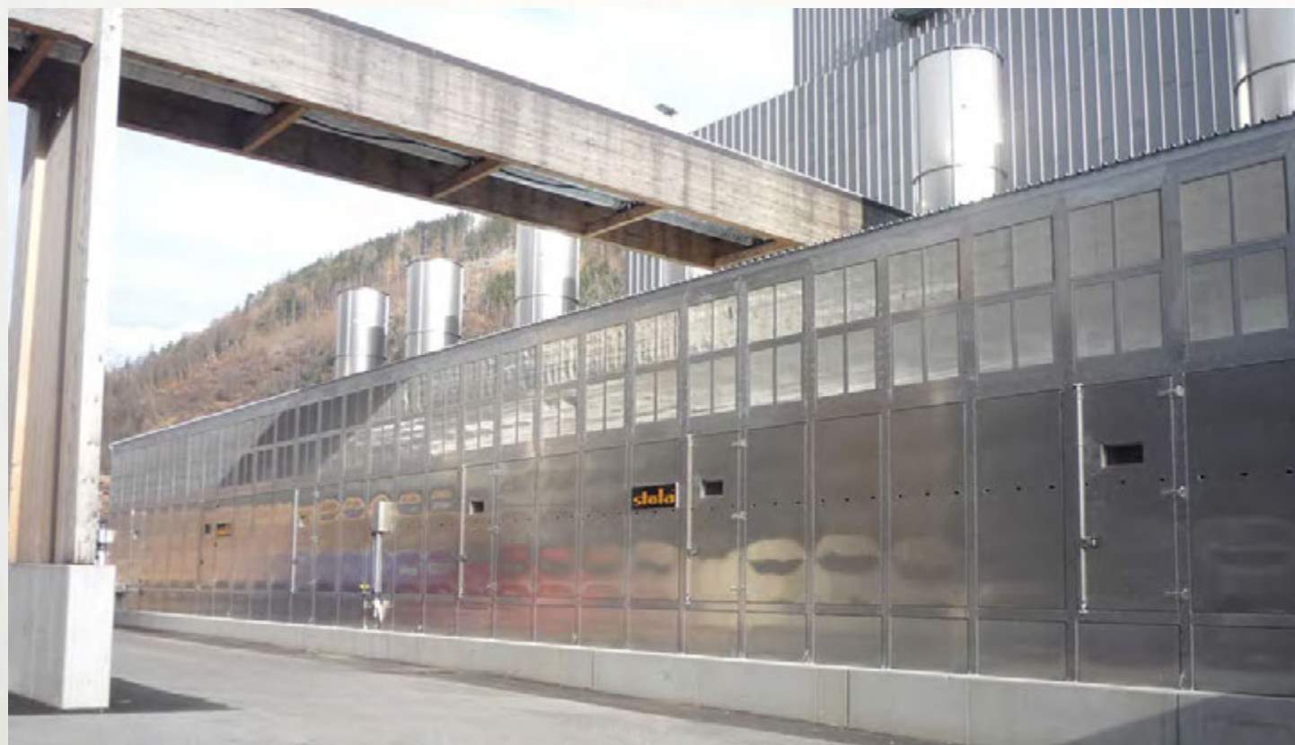
项目地：Hasslacher Energie, 奥地利 | 型号：BT 1/6200-46 | 安装年份：2023 干燥物料：木屑 | 出料能力：约30.0吨/小时 | 降水区间：50% - 10%湿度
