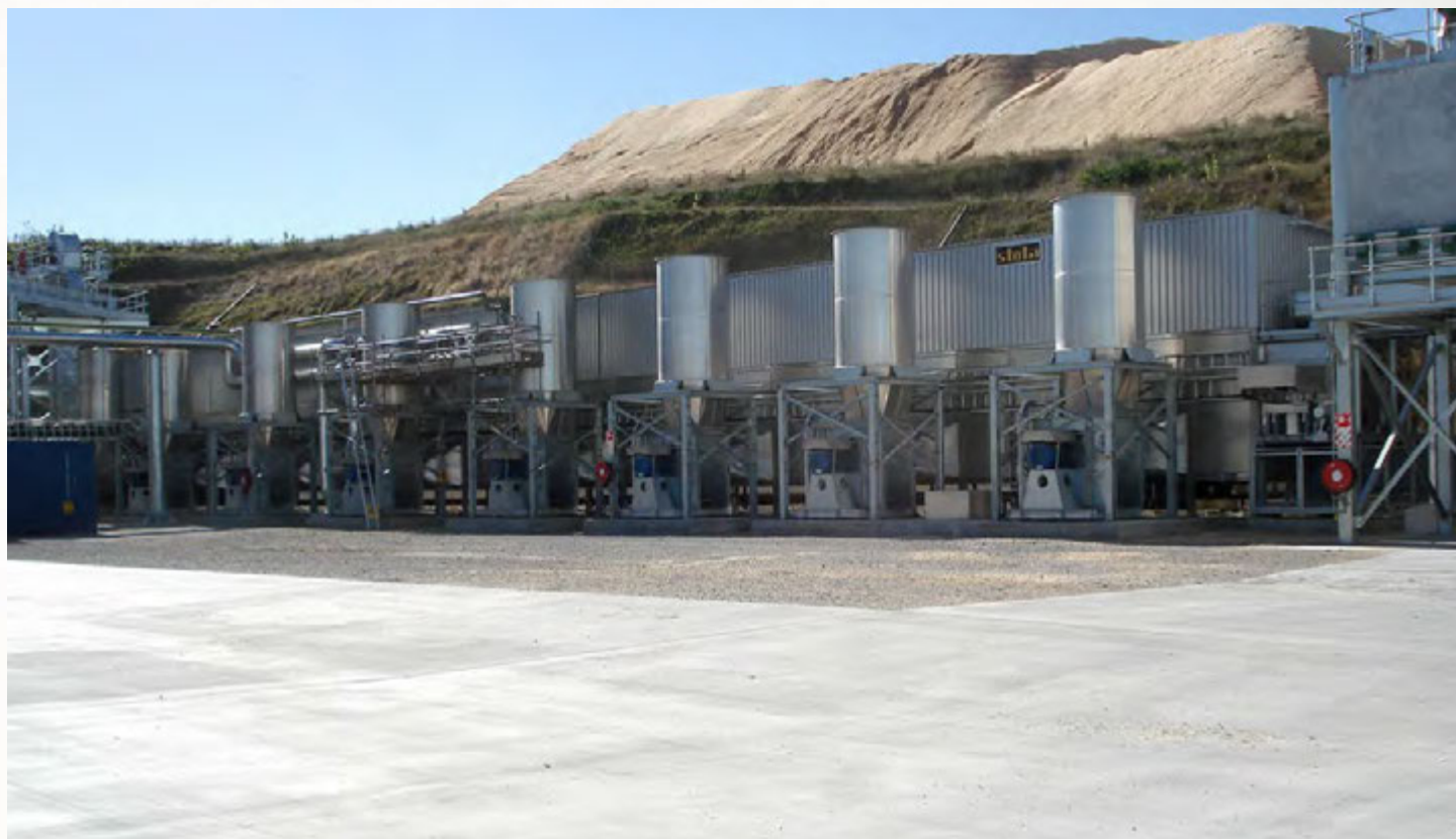
项目地：Nature's Flame, 新西兰 | 型号：BT 1/6200-52.5 | 安装年份：2009 干燥物料：木屑 | 出料能力：约12.0吨/小时 | 降水区间：60% - 10%湿度
