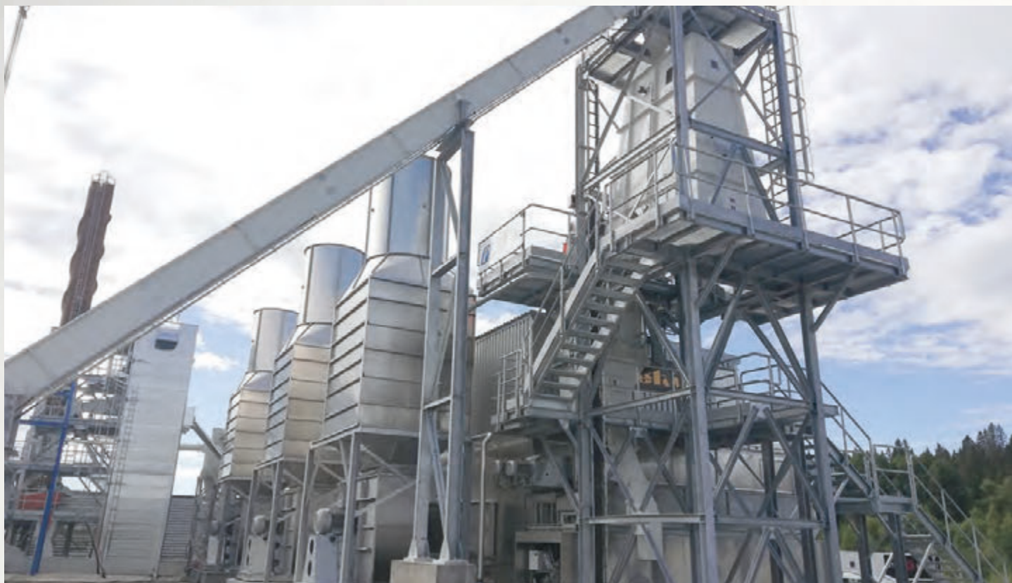
项目地：Grasco Site, 挪威 | 型号：BT 1/6200-24 | 安装年份：2020 干燥物料：木屑 | 出料能力：约16.0吨/小时 | 降水区间：53% - 38%湿度
