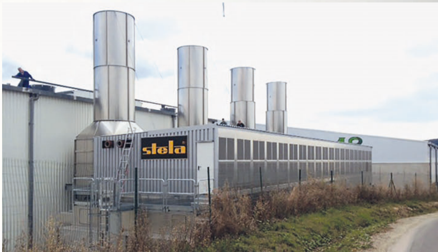
项目地：SAS B.C. 48, 法国 | 型号：BT 1/6200-30 | 安装年份：2016 干燥物料：木屑 | 出料能力：约8.4吨/小时 | 降水区间：50% - 8 %湿度
