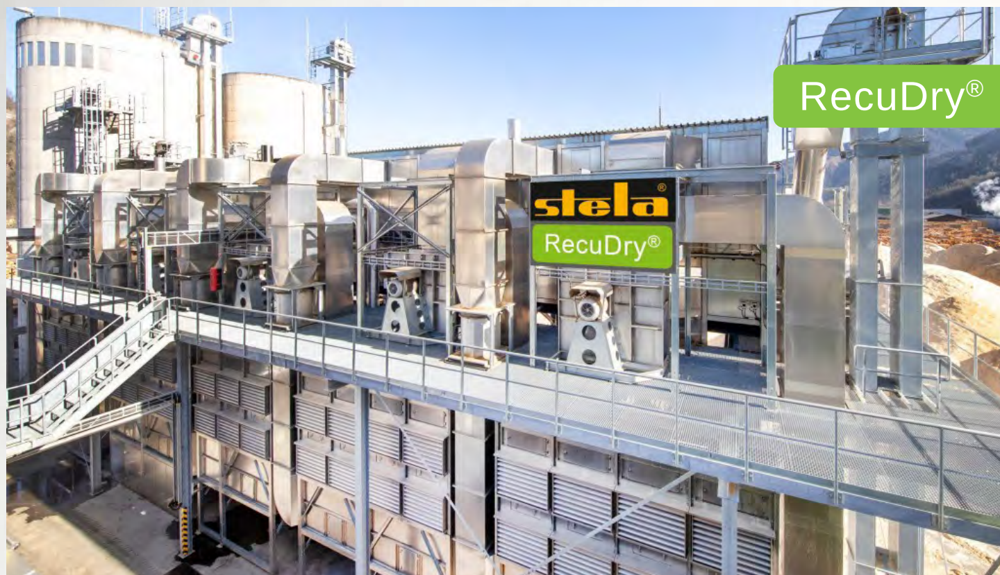
项目地：Mayr-Melnhof, 奥地利 | 型号：BTU RecuDry 2/6200-34.5 | 安装年份：2017 干燥物料：木屑 | 出料能力：约13.5吨/小时 | 降水区间：50% - 10%湿度
