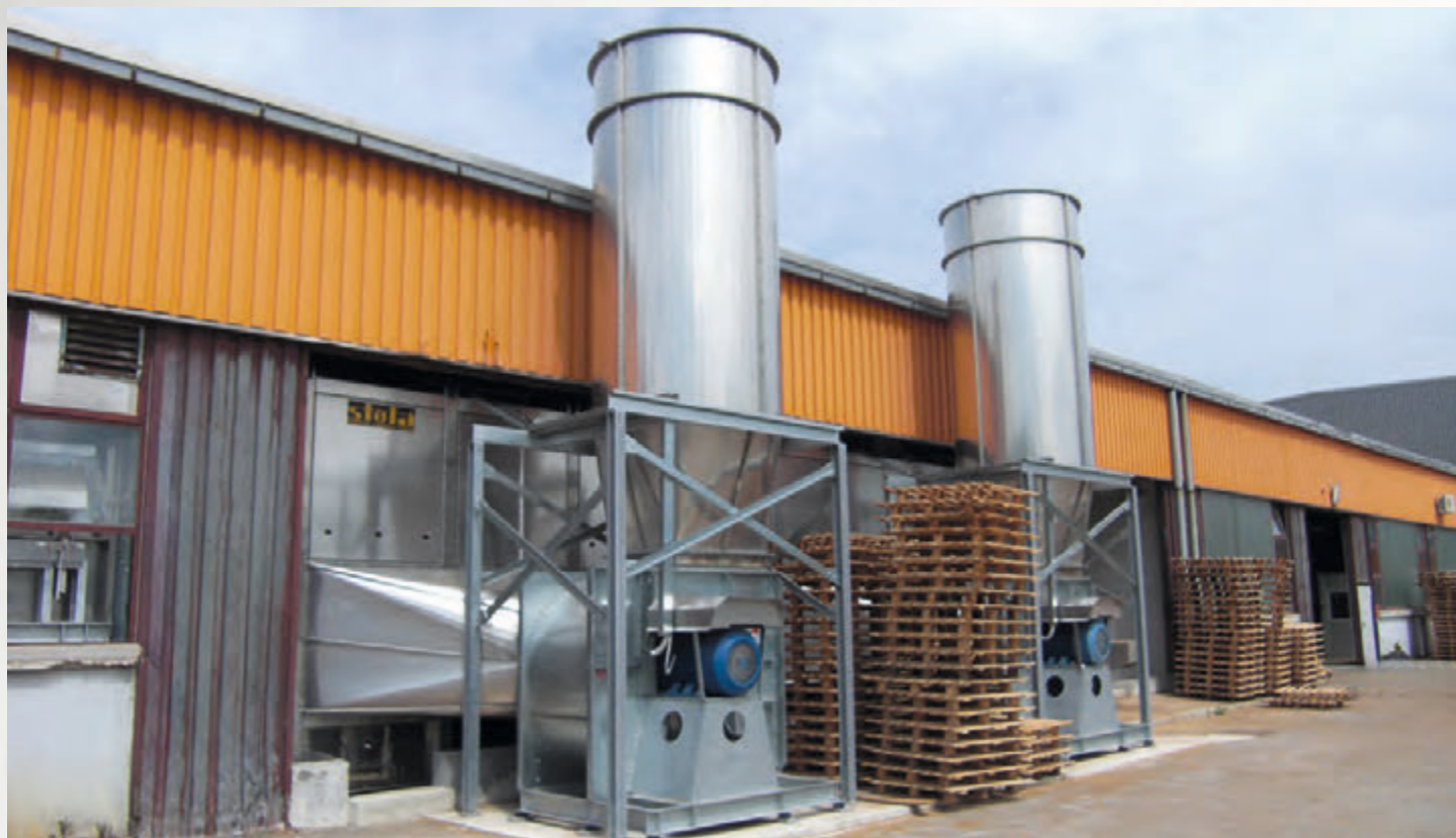
项目地: Moderator d.o.o., 克罗地亚 | 型号: BT 1/6200-13.5 | 安装年份: 2011 干燥物料: 木屑 | 出料能力: 约5.0吨/小时 | 降水区间: 45% - 10%湿度
