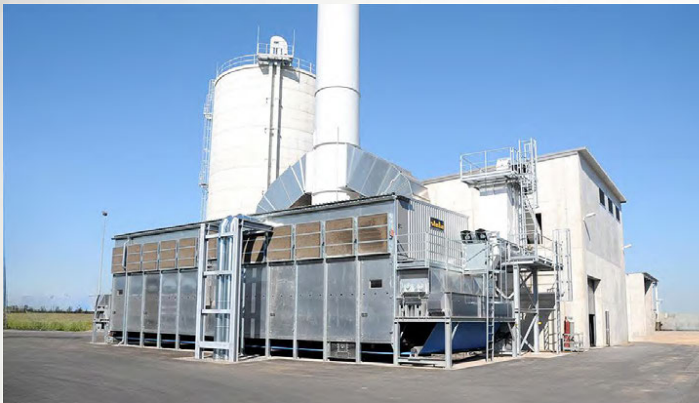
项目地：Bioenergie Aschaffenburg, 德国 | 型号：BT 1/6200-18 | 安装年份：2009 干燥物料：木屑 | 出料能力：约5.8吨/小时 | 降水区间：50% - 10%湿度
