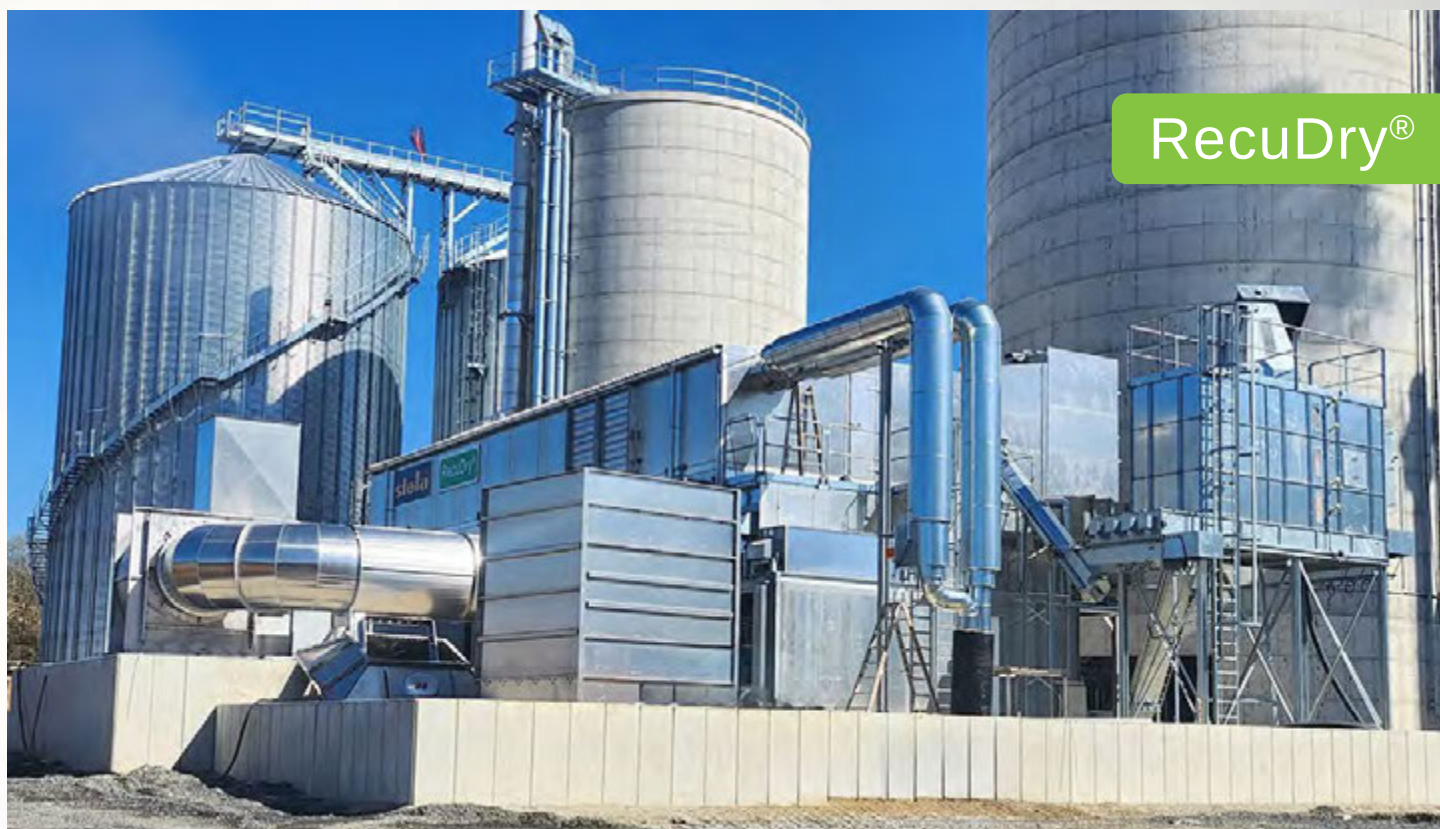
项目地：Holzindustrie Gustav Hassel GmbH, 德国 | 型号：BTU RecuDry 1/6200-18 | 安装年份：2022 干燥物料：木屑 | 出料能力：约4.1吨/小时 | 降水区间：50% - 10%湿度
